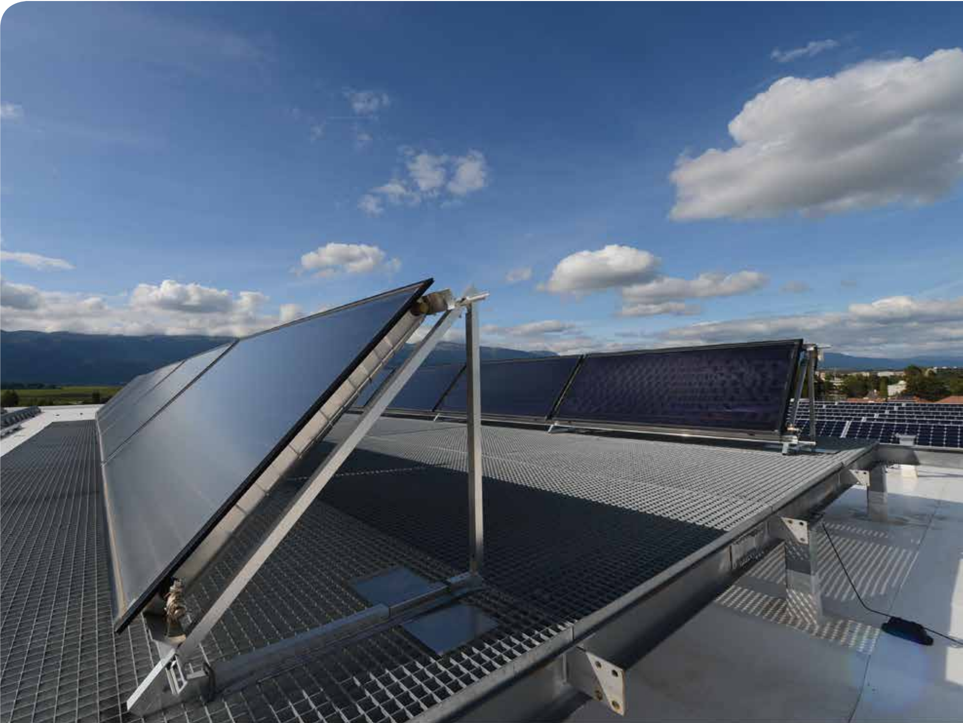
Photo : Zimeysa, panneaux solaires
